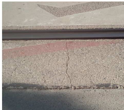
02.05.2017 bis heute gebrochene Bodenplatte
