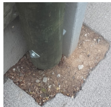
- eines von vielen Löchern in Gehsteigen nach Mastentausch
