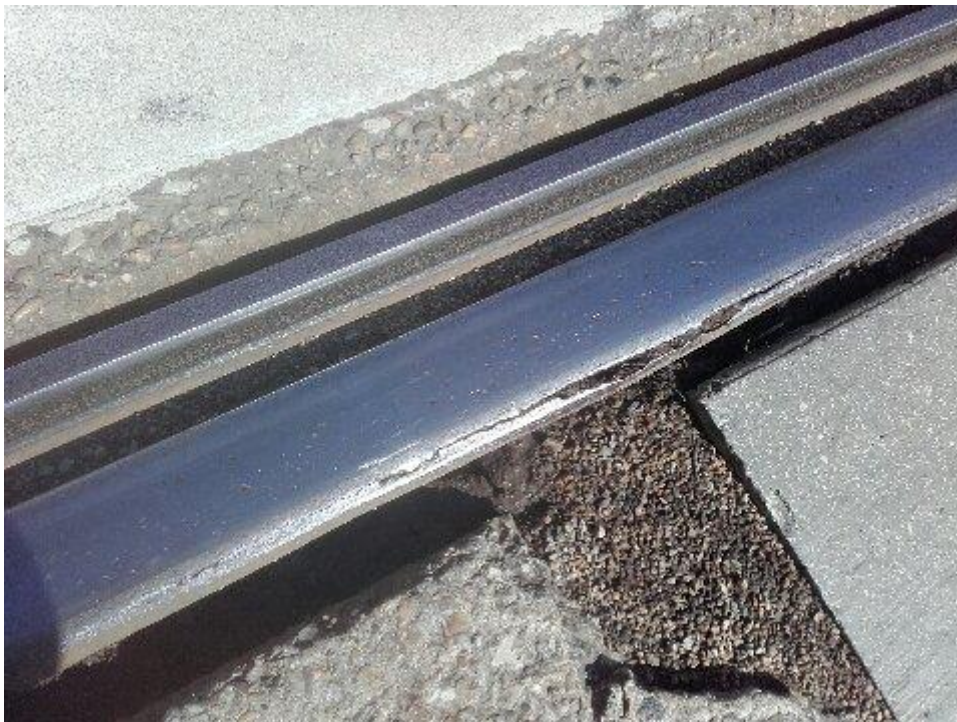
Durchrostende Schiene, Zebrastrifen # Hütteldorferstrasse - Zehetnergasse
