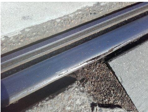
( Durchrostende Schiene, Zebrastreifen # Hütteldorferstrasse – Zehetnergasse )
