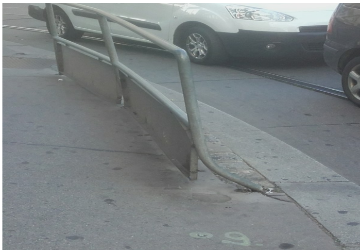
Angefahrenes, in den Gehsteig ragendes Schutzgeländer .
